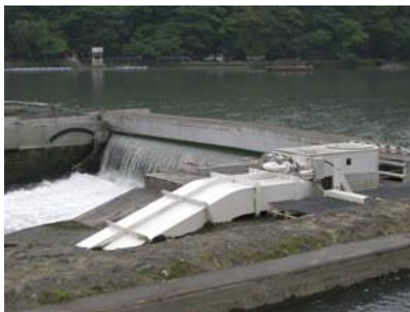
京都嵐山 桂川の小水力発電装置
